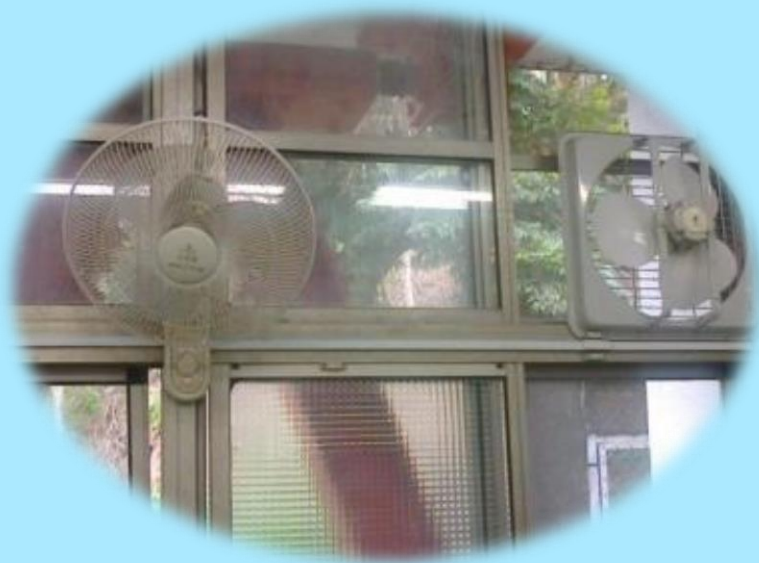
室內環境改善 -壁扇與排風扇促進空氣流通
