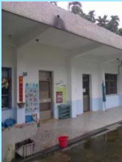
利用水桶接收 屋頂雨水再利用
