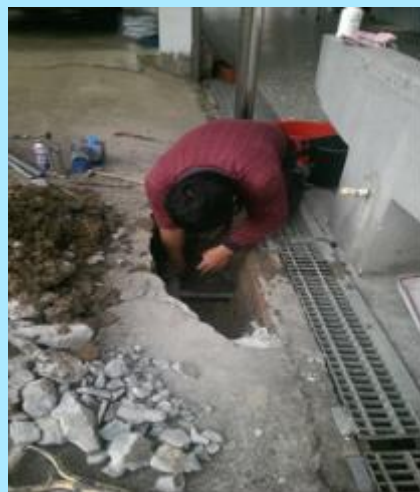
水管接頭破裂， 處理大量漏水問題。
