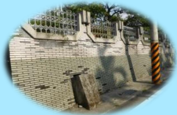
1. 圍牆老舊壁磚剝落
